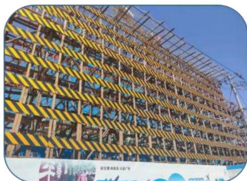
图 44 外电高压线路防护
