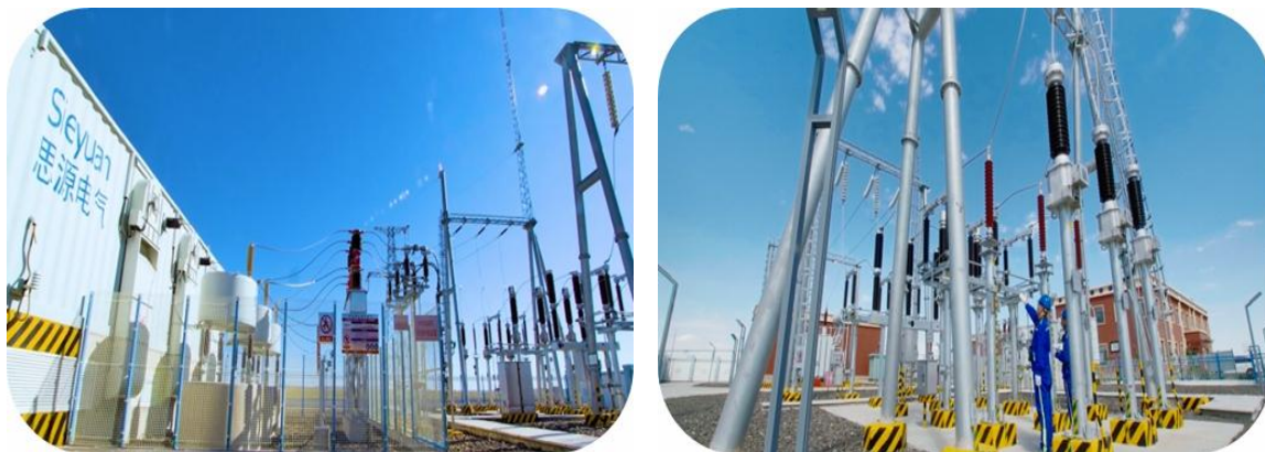
图 36 变电站警示线设置
