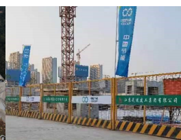
节能科技公司 新龙国际商务区区域供 冷供热能源站项目
